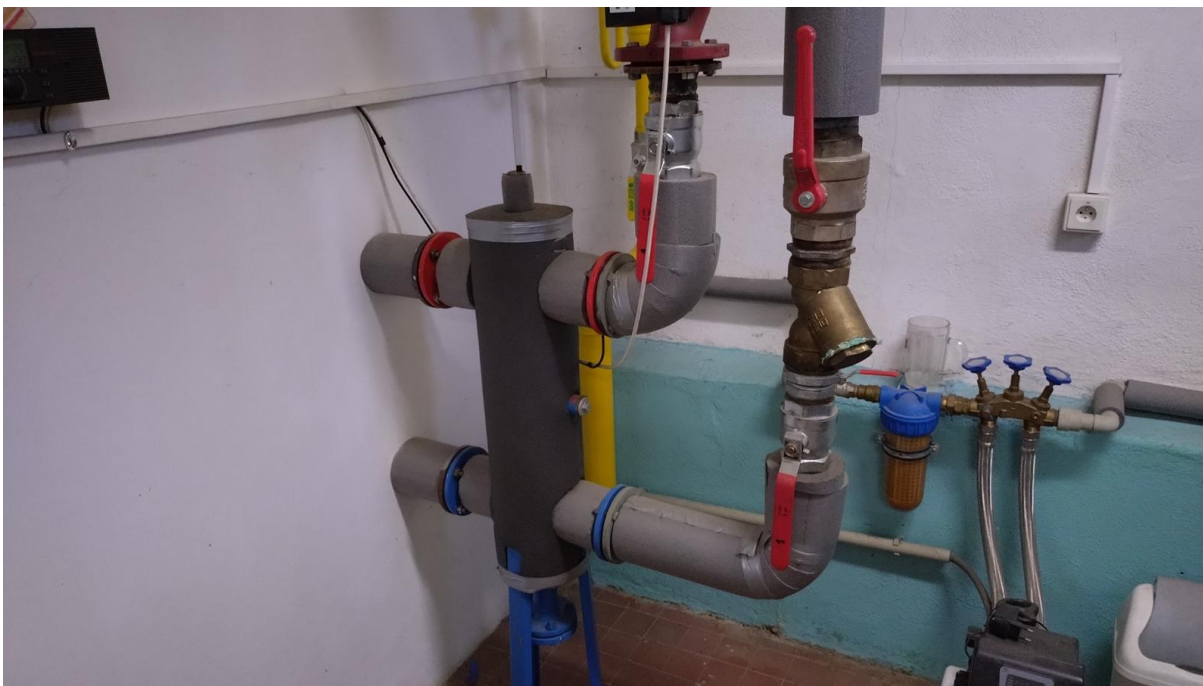
obr. 4 Pohled na termohydraulický rozdělovač
