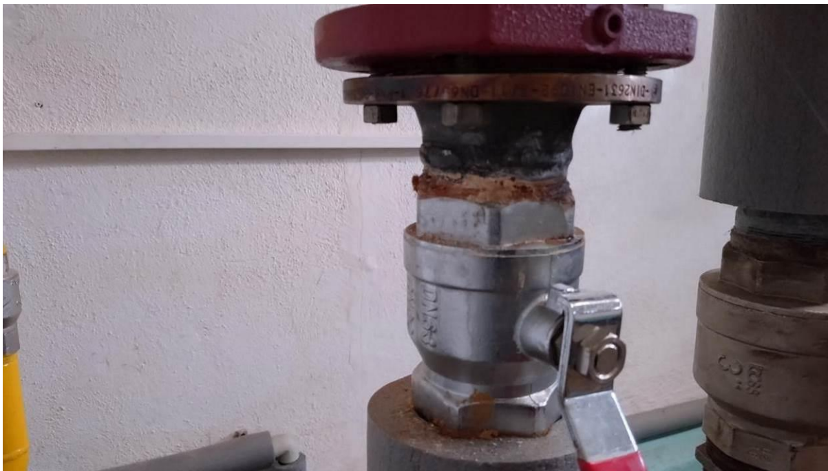
obr. 7 Uzavírací armatura zasažená korozí
