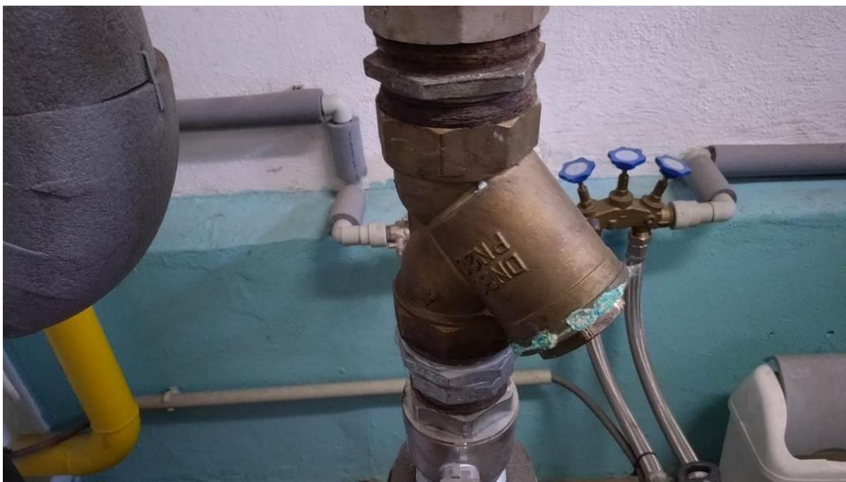
obr. 8 Filtr zasažen korozí
